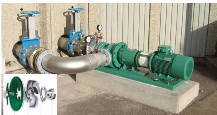
Vaughan chopperpump installation för jetomrörning
